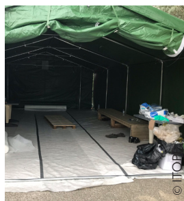
Exemple d'équipement sur le site de nettoyage
